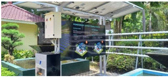
Gambar. 9. PLTS Off Grid, Panel box proteksi, dan Box baterai
