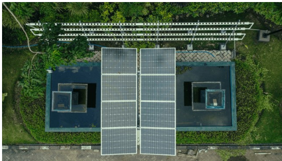
Gambar. 10. PLTS Off Grid tampak atas
