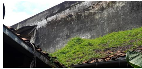
Gambar 13. Kondisi Atap Sebelum Restorasi (Berlumut) Sumber: Christine, 2024
