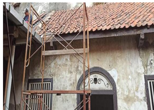
Gambar 8. Kondisi Kerusakan Cat Dinding Interior Sumber: Christine, 2024
