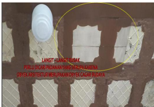
Gambar 18. Kondisi Plafon Sebelum Restorasi Sumber: Christine, 2024
