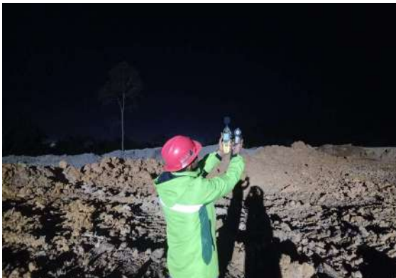
Gambar 10. Pengecekan standar penerangan di area kerja WMP 04 GT ketika di shift 2
